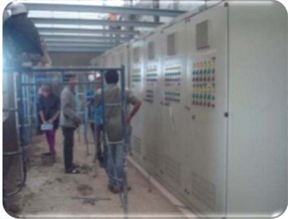
โรงไฟฟ้า โซลจัย
